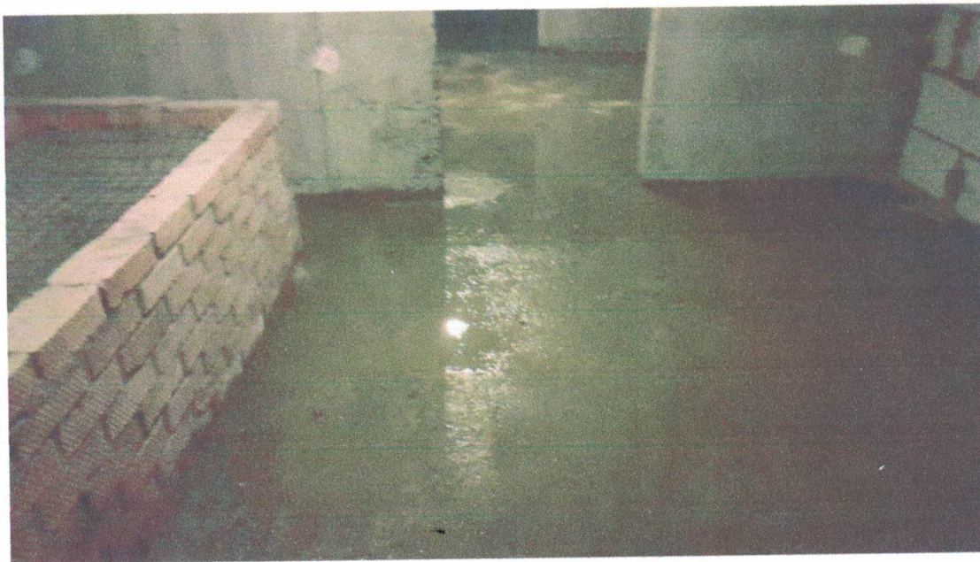
Фото 5. Следы протечек кровли.
