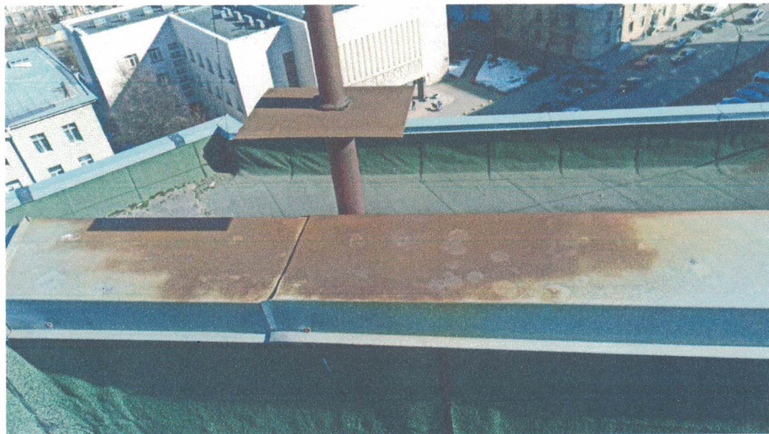
Фото 36. Ржавление окрытий парапетов. Отсутствует гидроизоляция стыков окрытия парапетов. Вздутие гидроизоляционного ковра. Отслоение гидроизоляционного ковра.
