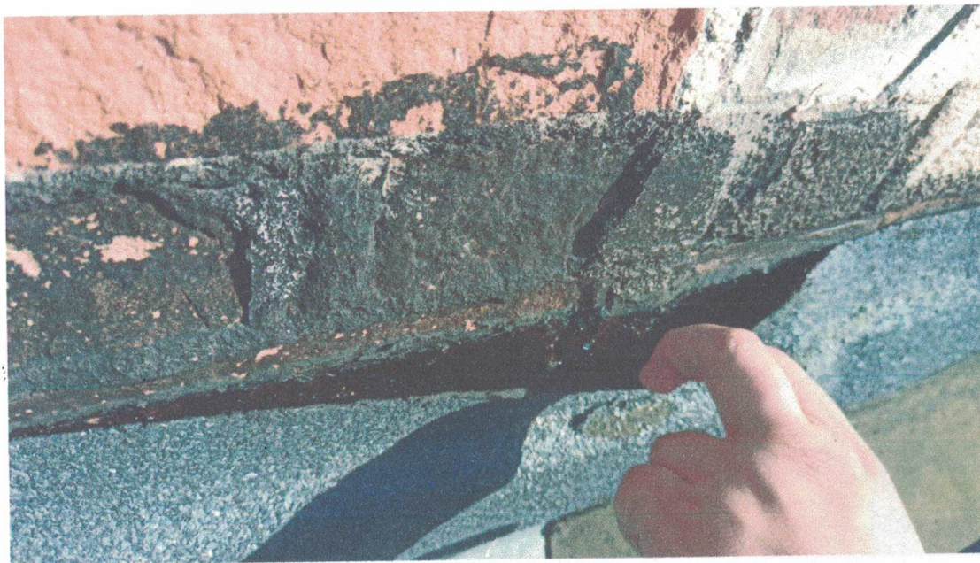
Фото 6. Отслоение гидроизоляционного ковра.
