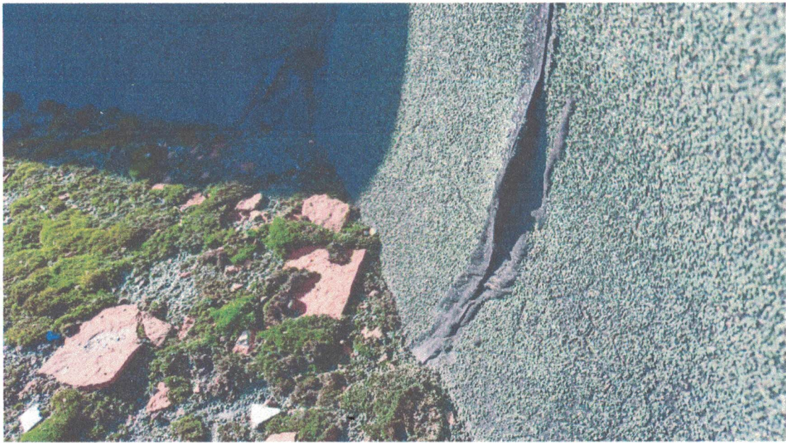
Фото 11. Загрязнения кровли. Отслоение гидроизоляционного ковра. Биологические поражения кровли.
